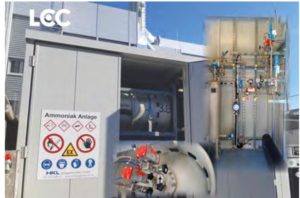
Abbildung 1: Ammoniakversorgung im mobilen Container
